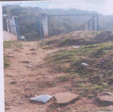
Foto 10: Tota de cemento entrada principal a la escuela.
