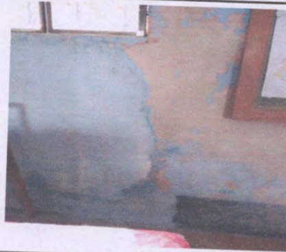
Foto 2: Repello de pared de aula de primero, segundo y tercer grado.
