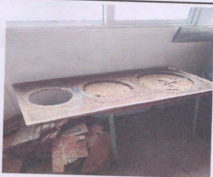
Foto 5: Plancha de cocina esta completamente oxidada
